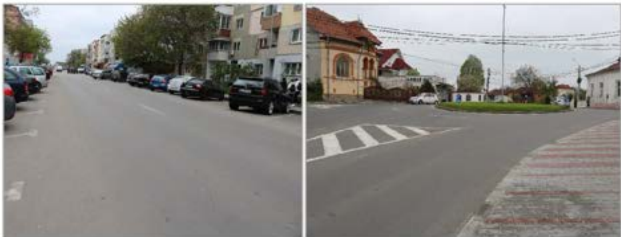
Figura 2.25. Străzi a căror suprafață de rulare se află în stare tehnică bună (Exemplificare).
