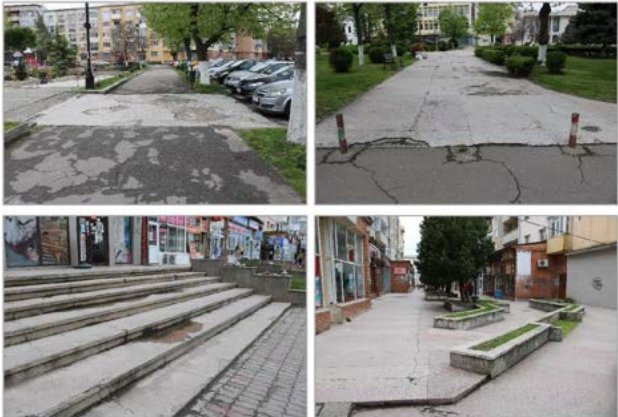
Figura 2.60. Spații pietonale degradate în zona centrală.
