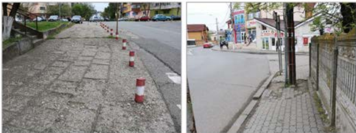
Figura 2.47. Trotuare în stare necorespunzătoare (Exemplificare).
